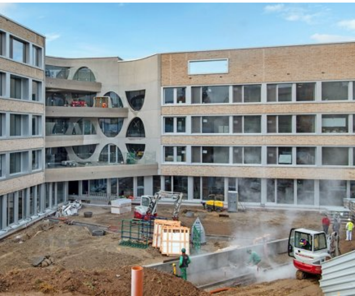
Des retards et des surcoûts ont été constatés sur le chantier de Cery. La Commission de gestion s'en est inquiétée. DR
